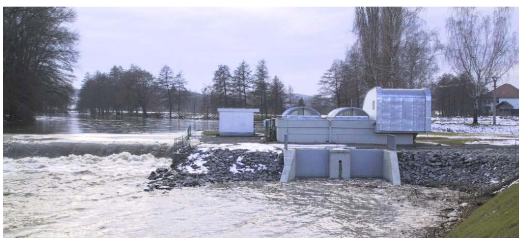
Obr.5.19 Malá vodní elektrárna na řece Jihlavě, vaková hradicí konstrukce (Ivančice)
